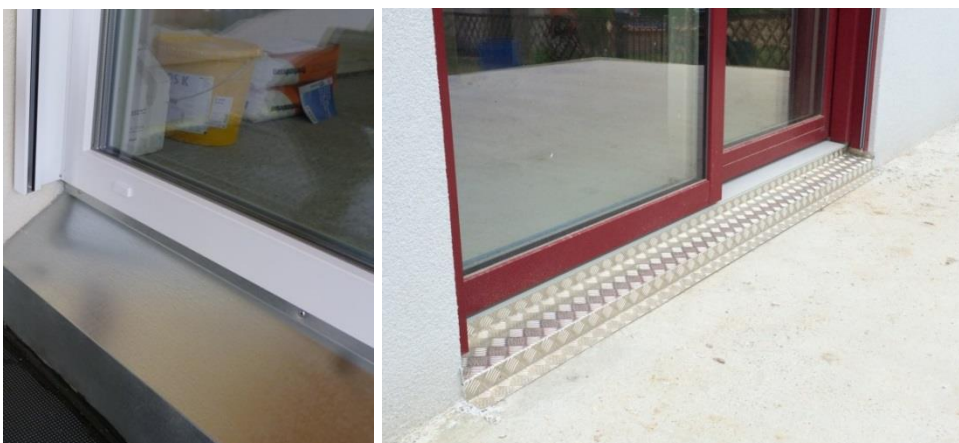
Abbildung 5: Sohlbankausführung/ Verblechung bei Terrassentür mit großer Neigung für den noch kommenden in die Türleibung reichenden Holzterrassenanschluss (li.) und trittfeste Ausführung mittels Riffelblech (re.)
