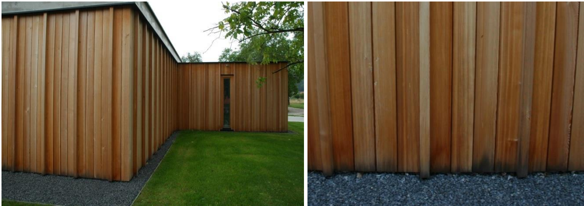
Abbildung 8: Ausführung einer Holzfassade mit vertikaler Schalung ohne ausreichenden Spritzwasserschutz. Erste Verfärbungen sind bereits nach kurzer Dauer sichtbar.
