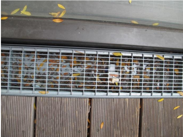
Abbildung 10: Entwässerungsrinne mit Laub und Schmutz gefüllt. Diese ist regelmäßig zu reinigen bzw. zu warten um einen dauerhaften Wasserablauf zu gewährleisten.
